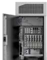
電信設備主機
