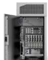
電信設備主機
